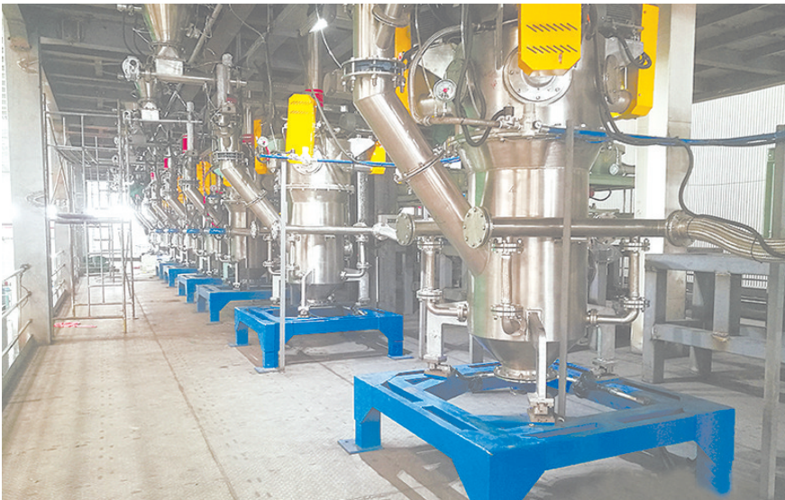
图为山东埃尔派粉体科技有限公司磷酸铁锂和单晶三元气流粉碎机生产线。
